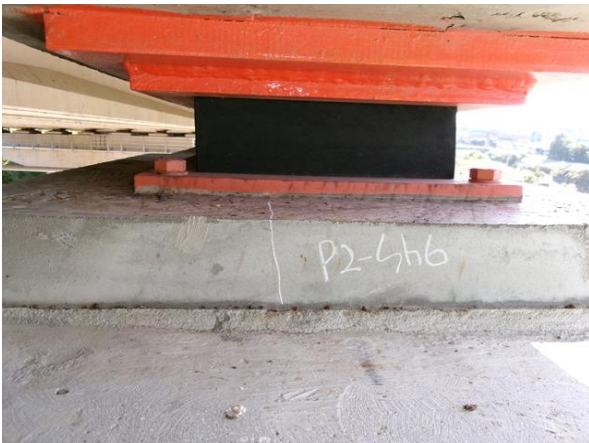
P2-Sh6 무수축물탈 균열(Cw=0.3mm미만)
