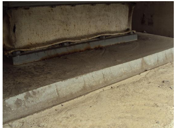
P6-Sh6 무수축물탈 균열(Cw=0.3mm미만)
