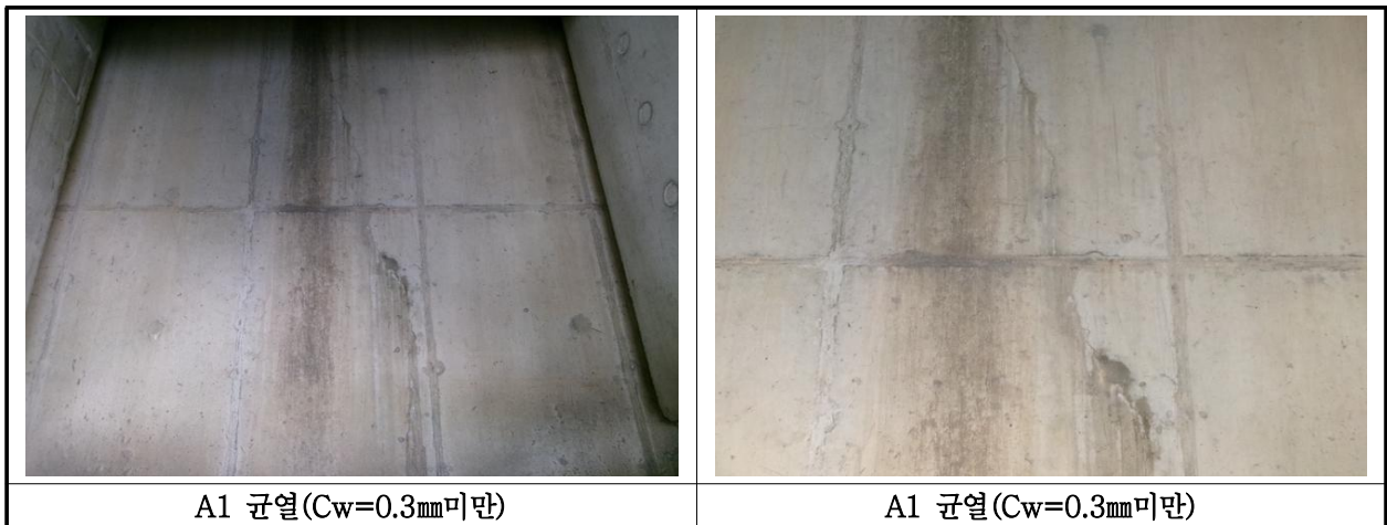
【사진 34.3.9】 교대 손상현황
