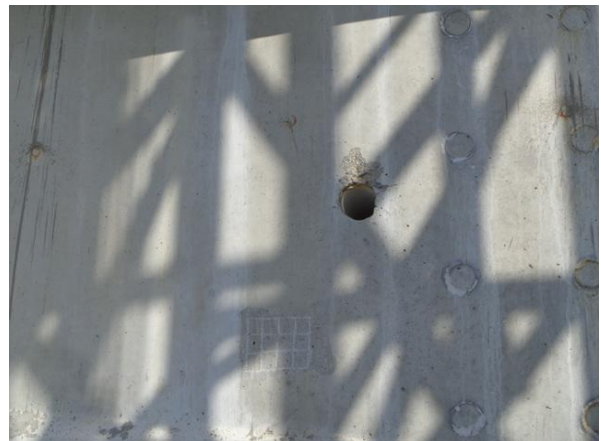
S6-G1 인양홀 파손(0.1×0.1)
